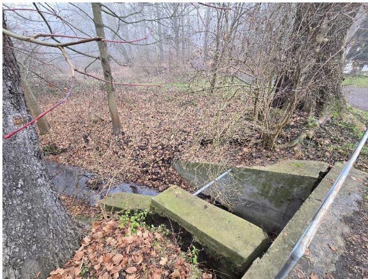
Bod č. 28 – bezpečnostní přepad v havarijním stavu
