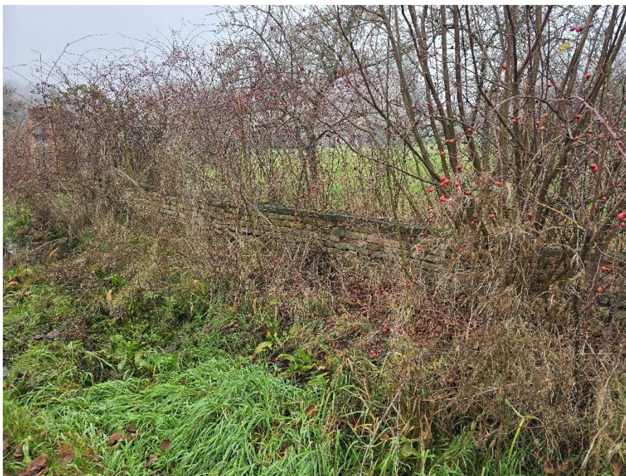
Bod č. 9 – špatný stav přilehlé zídky, hrozí zřícení do toku
