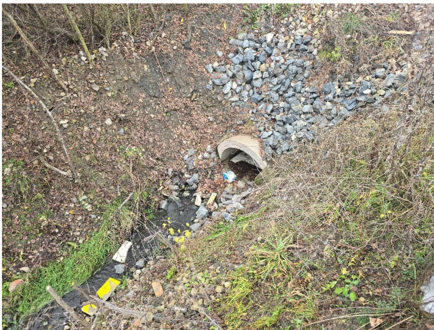
Bod č. 24 – sesunutý břeh u vyústění propustku
